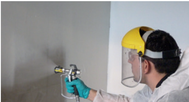
Maschineller Auftrag von MasterProtect 330 EL zum rissüberbrückenden Schutz gegen Karbonatisierung einer Tiefgaragenwand aus Beton.
